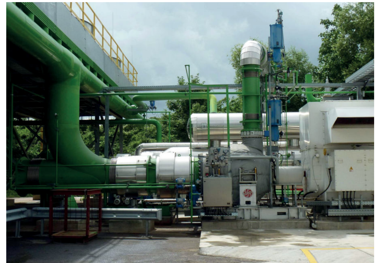
OCR-Anlage und Luftkühlung © Stober
