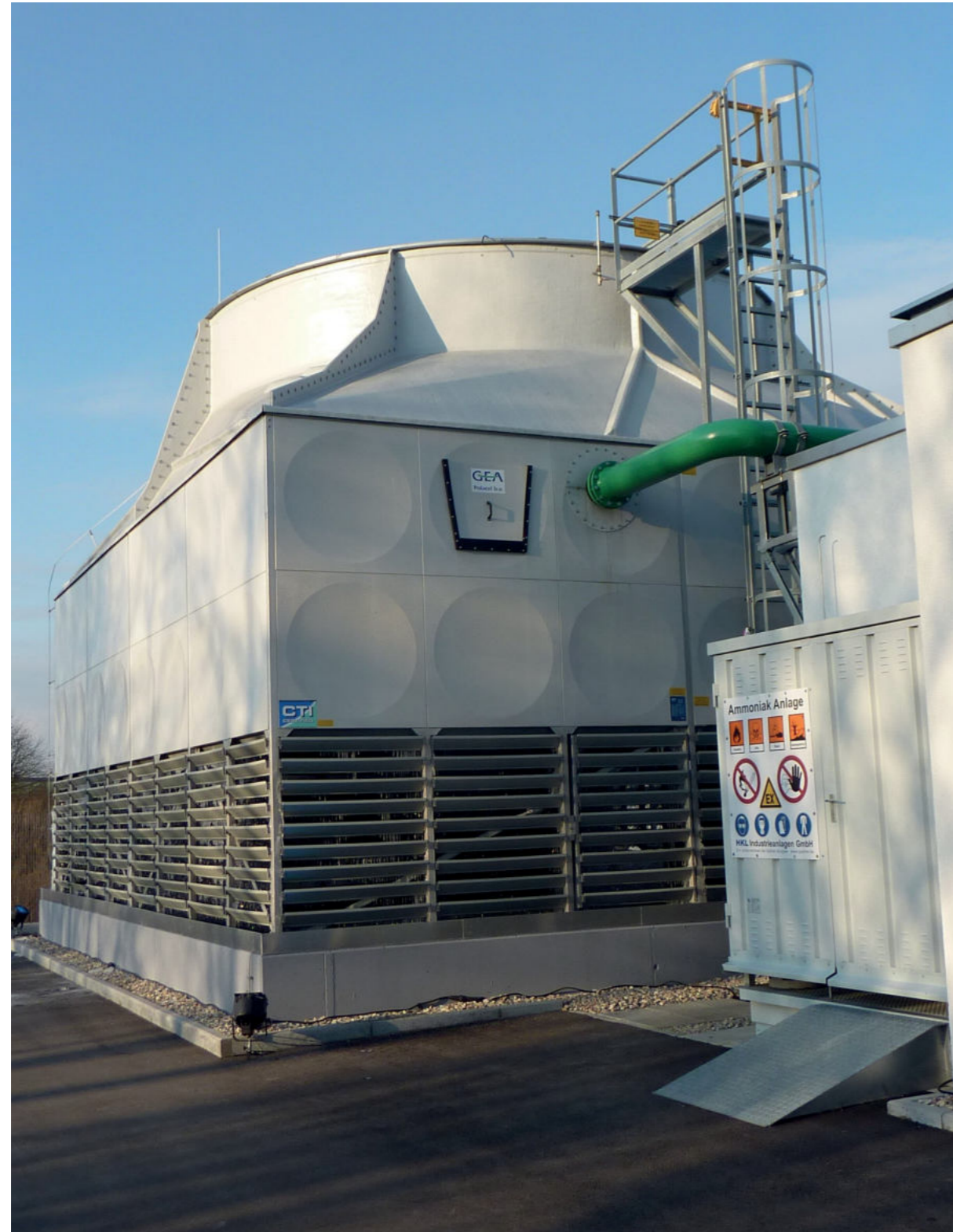
Nasskühlturm Bruchsal © Stober
